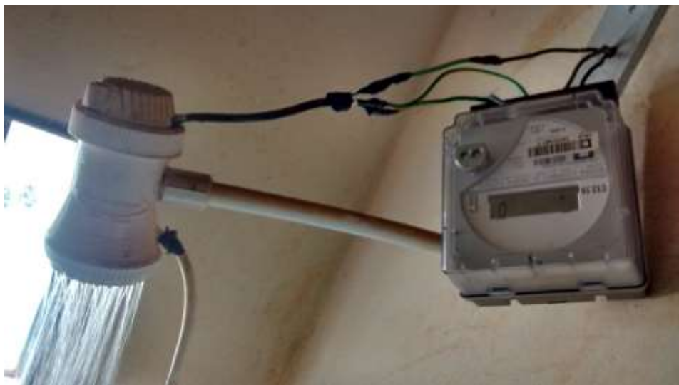
Figura 14: Medidor de energia utilizado
